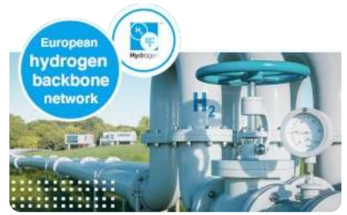
欧洲氢气管道
